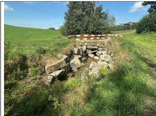
Längsverbau oberhalb Durchlass eingestürzt
