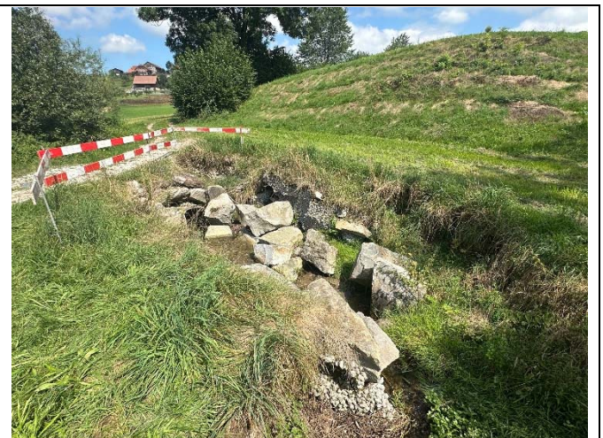
Längsverbau oberhalb Durchlass eingestürzt
